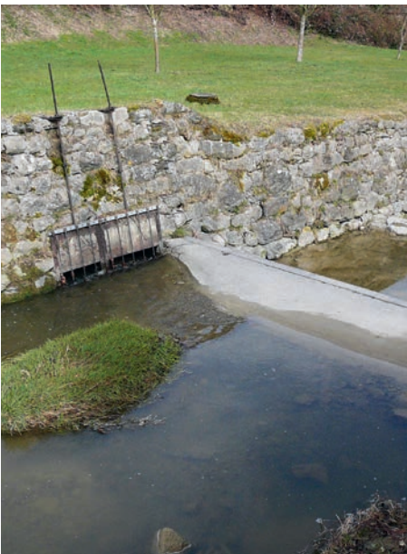
Wasserentnahme für das Kraftwerk Tal- mühle. Die Gitterabstände sind zu weit. Fi- sche dürften nicht hindurch gelangen.
